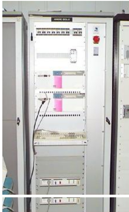
Armoire oscillo installée en salle de relaying
